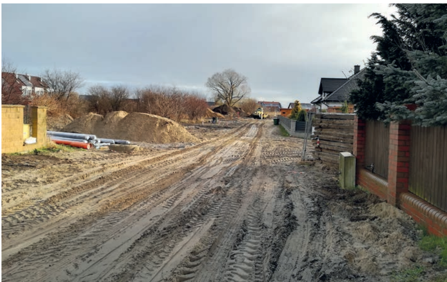
Sieć kanalizacji deszczowej na ulicy Władysława Komara.
